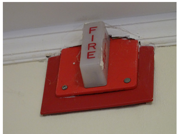
フラッシュライト付きの火災報知器（著者撮影）
