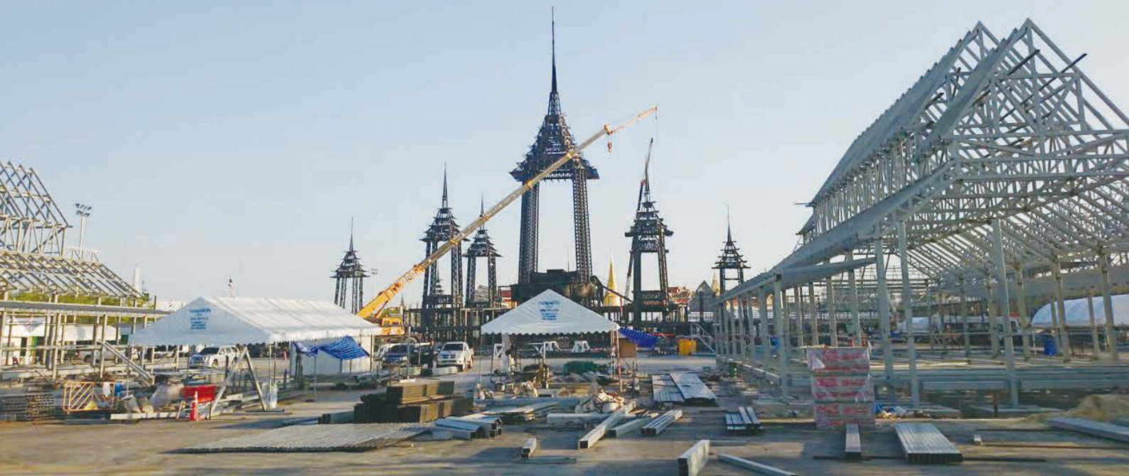
建設途中のプラ・メルマート。巨大なクレーンを使って鉄骨を組み上げる（2017年5月）
