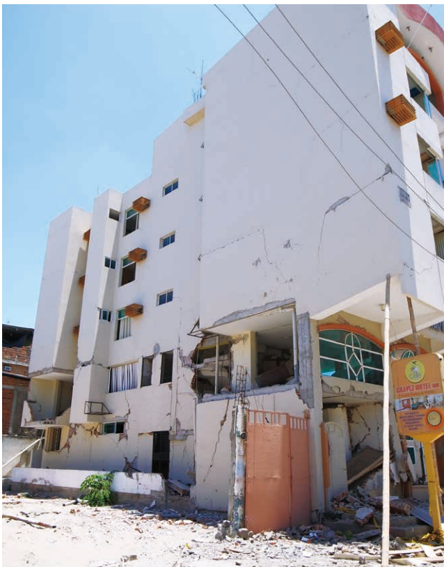
倒壊寸前の住宅マンション
