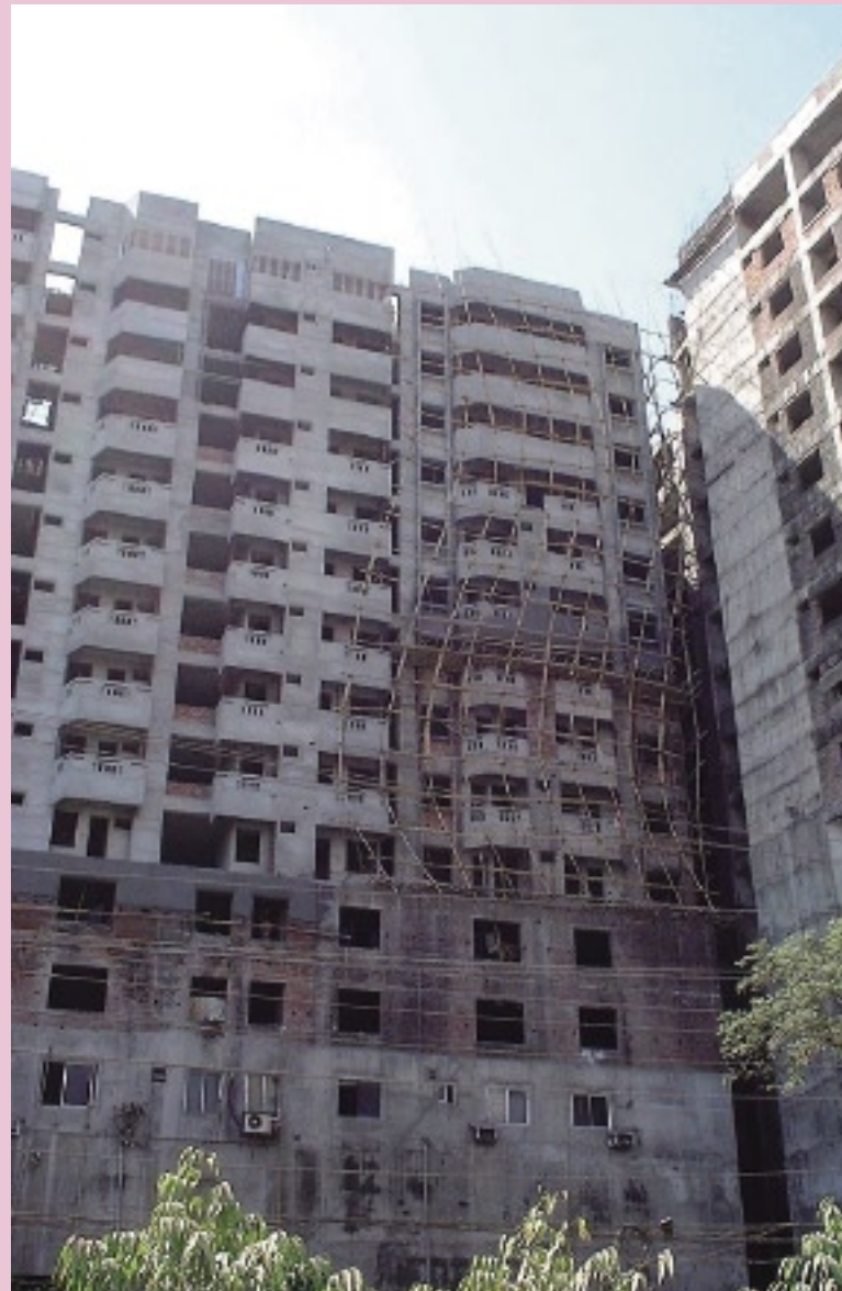
ダカ市内の建築現場。わざと曲げたのかと思うほど芸術的に、足場が歪んでいる（2006年、ポリバークにて）
