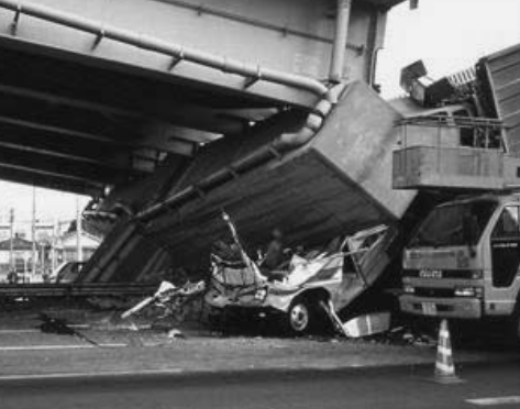
崩壊した高速道路（筆者撮影）
