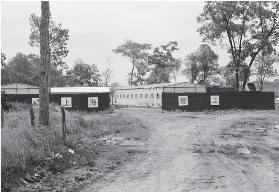
僻地で道路建設を行っている中国企業（ブレアヴィヒア州、2009年5月撮影）
