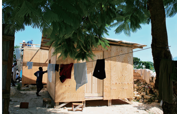
日本のNGOにより建設された仮設住宅。広さは18平方メートル
