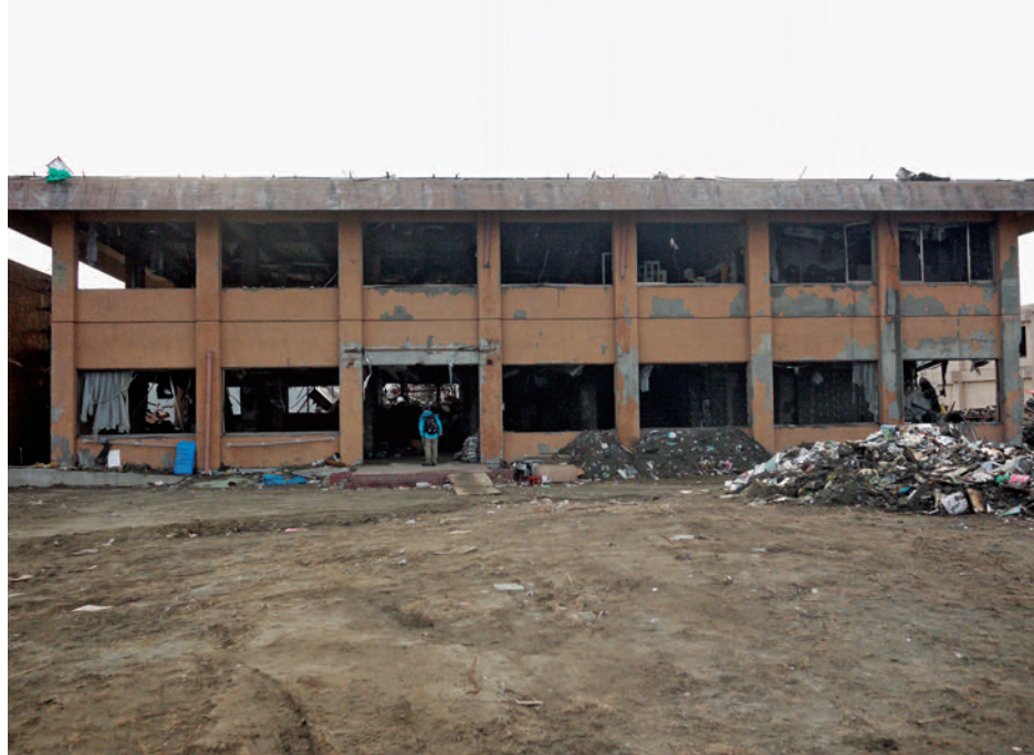
壊滅状態の陸前高田市立図書館
