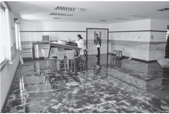
浸水後のランシット校図書館。壁に水跡が残る
