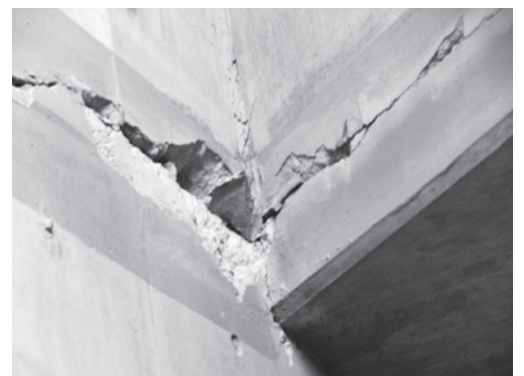
一部落下したコンクリート壁
