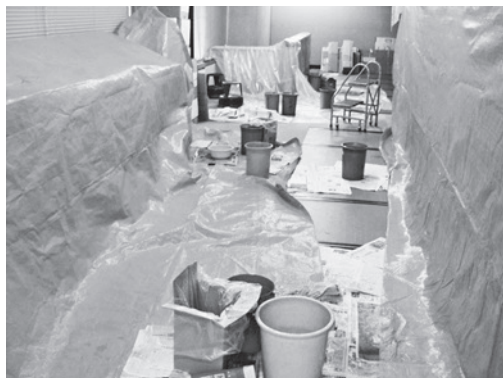
地下書庫の漏水
