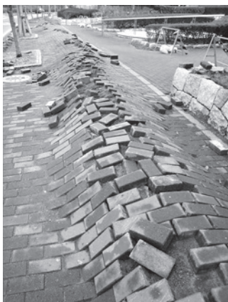
②海浜幕張周辺の隆起した歩道
