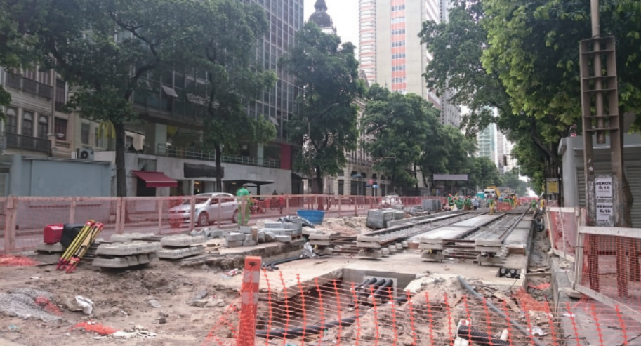
写真13 2015年11月に訪問した際の中心街の目抜き通りリオ・ブランコ大通り。週末であったが、ライト・レイル鉄道VLTの敷設工事が進められていた
