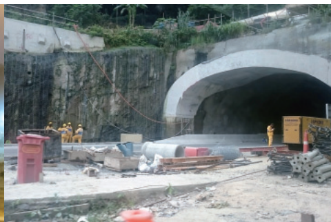
写真3 アクセスの良くないバハ地区へ新たな道路を敷設すべく行われていたトンネル工事。バハ地区はリオの国際空港や市中心街から約30km離れており、かなり遠隔地にある
