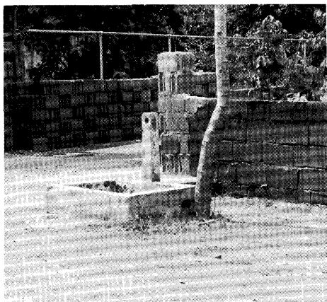
壊されて使用不能となっているプロジェクトの水道栓(南タガログ地方:地方環境衛生パイロット・プロジェクト)
