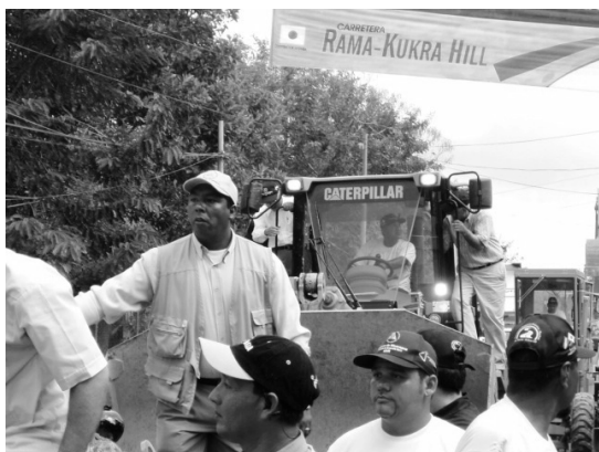
写真22. エル・ラマククラ・ヒルラグナ・デ・ペルラス農道建設開始
