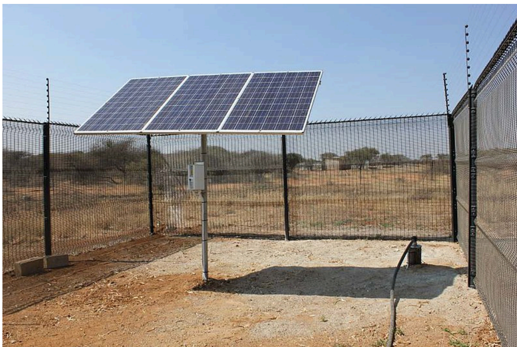
写真 1 ボツワナのモチュディ市で使用される太陽光発電ポンプシステム
