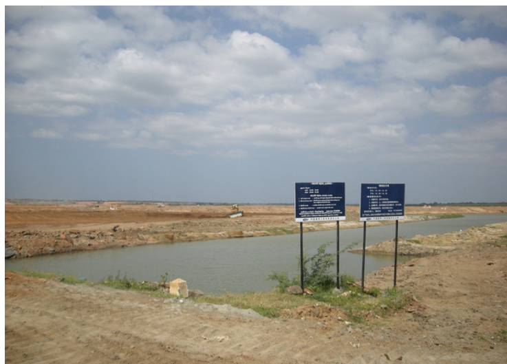
2009 年のハンバントタ港建設の様子。誰もいない建設現場（著者撮影）
